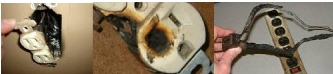
图 2.7 因接触电阻和大负载造成线路烧毁故障
